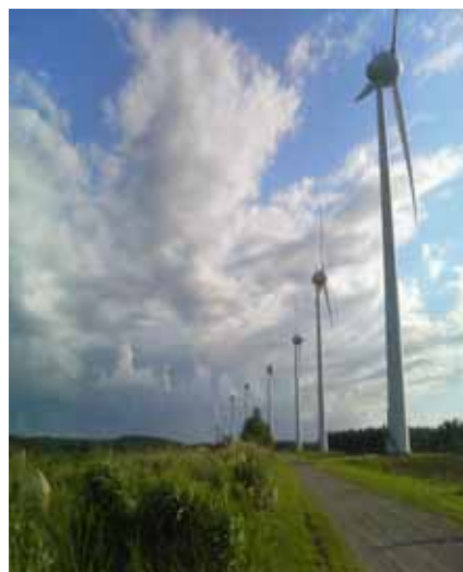
Photo 1(a) 能代風力発電所
